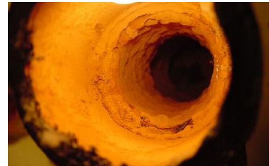
Las biofilms y el material orgánico pueden acumularse en las líneas de agua con el tiempo llevando a un flujo de agua reducido.
