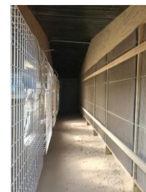
Trampa de luz en una pared falsa delante de los ventiladores del túnel.
