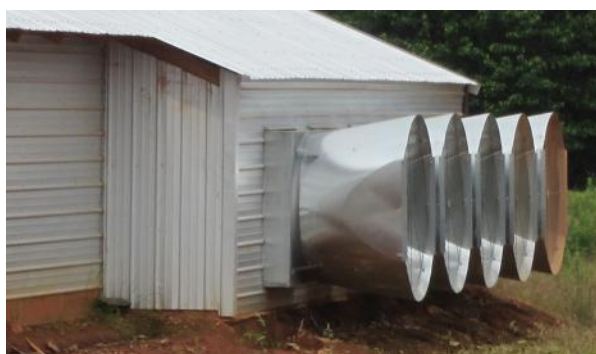
Pared falsa de trampa de luz de ventilador de túnel instalada en "casetas para perros" o plenum frente a ventiladores de túnel instalados a los lados de la caseta.
