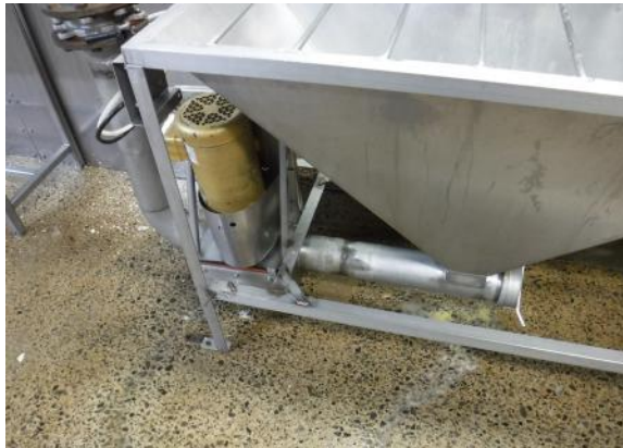
Repare las fugas para mantener el material orgánico y el agua contenidos. Los microorganismos los necesitan para sobre vivir.
